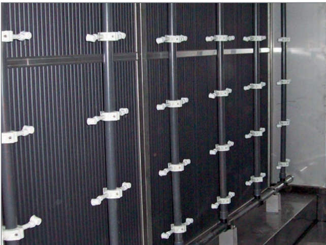
UMIDIFICAZIONE AD UGELLI
