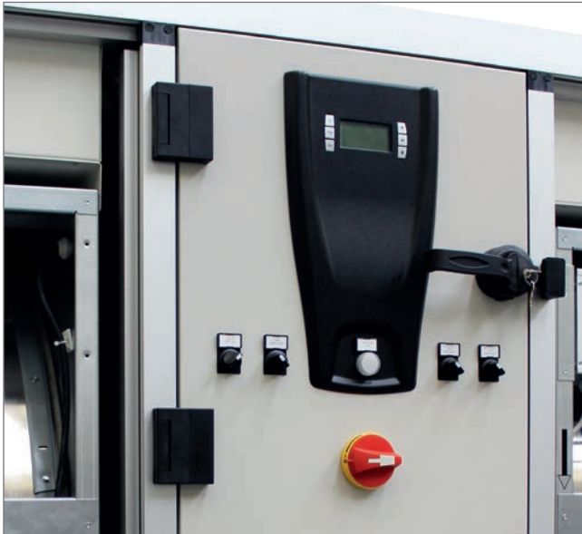
QUADRO ELETTRICO CON DISPLAY
