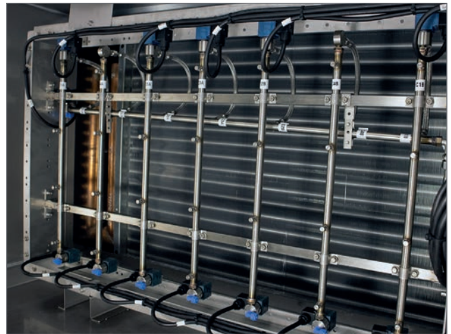
UMIDIFICAZIONE AD ACQUA IN PRESSIONE
